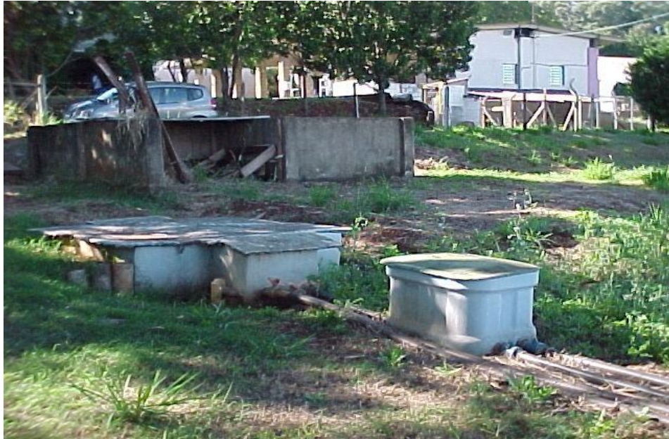
Figura 4.2 - Caixa de passagem.
