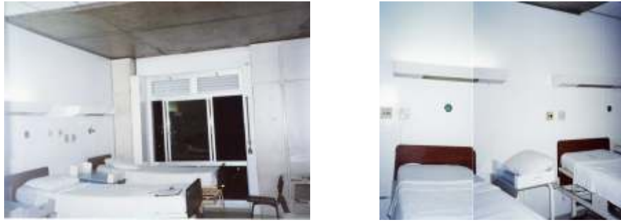
FIGURA 6.70 e 6.71 - Apenas as luminárias posicionadas sobre leitos desocupados estavam ligadas
