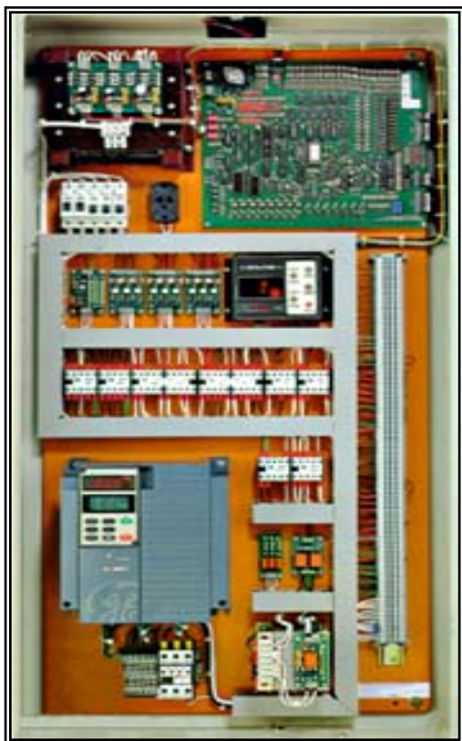
Ilustração 44 - Quadro de comando. Fonte: www.thyssenkrupp Junho 2007
