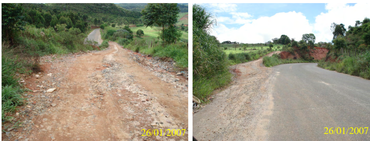
Figura 20 – Vias de acesso ao aterro e vista da entrada sem a existência de sinalização e portão
