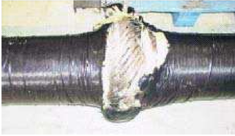
Figura 7.10: Duto flexível apresentando falha por instabilidade das armaduras.
