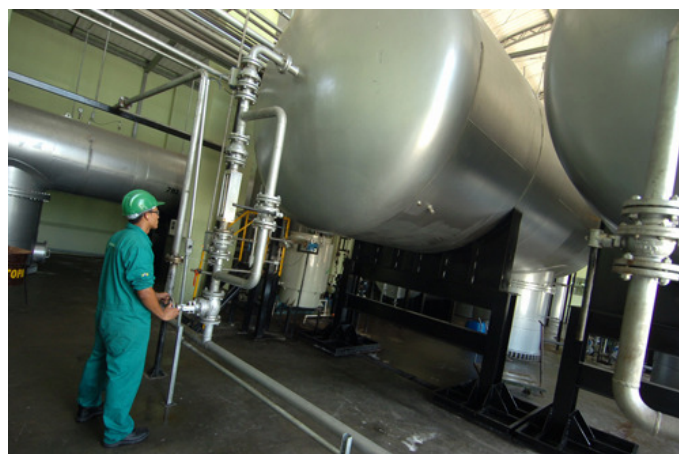
Figura 12 - Foto Parcial de um Tanque de Reação de Biodiesel
