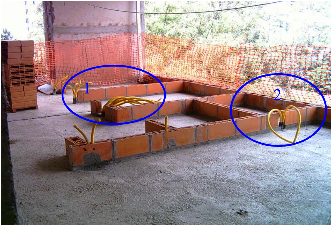
FIGURA 5.9 – Interferência alvenaria – instalações elétricas Fonte: Empresa pesquisada (Obra A)
