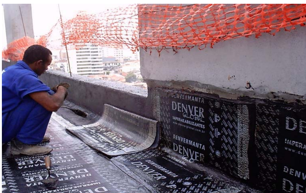
FIGURA 5.10 – Alvenaria de cobertura (apartamento duplex) sem nicho para receber a manta asfáltica
