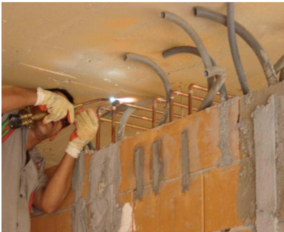
FIGURA 5.25 – Passagem de eletrodutos e da tubulação de gases para posterior liberação da concretagem dos blocos tipo canaleta Fonte: Empresa pesquisada (Obra C)
