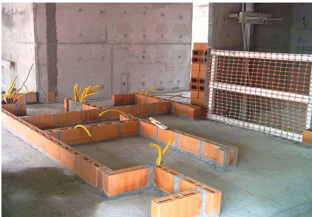
FIGURA 5.17 – Interferência alvenaria – instalações elétricas Fonte: Empresa pesquisada (Obra B)
