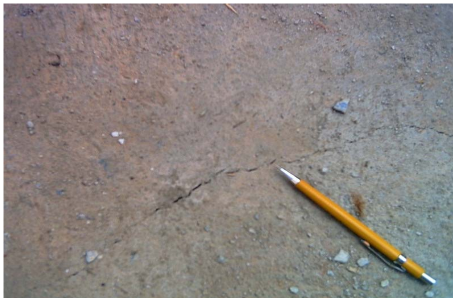
FIGURA 5.11 – Fissura na laje de concreto do 3º pavimento tipo Fonte: Empresa pesquisada (Obra B)
