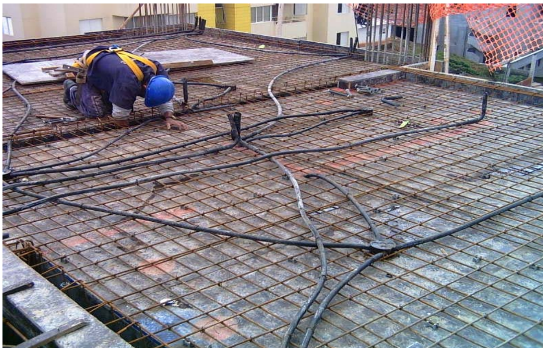
FIGURA 5.16 – Posicionamento em laje de eletrodutos, caixinhas de teto e shafts Fonte: Empresa pesquisada (Obra B)
