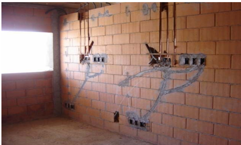
FIGURA 5.31 – Rasgos nas alvenarias para passagem de eletrodutos e tubulação de cobre de gases medicinais Fonte: Empresa pesquisada (Obra C)
