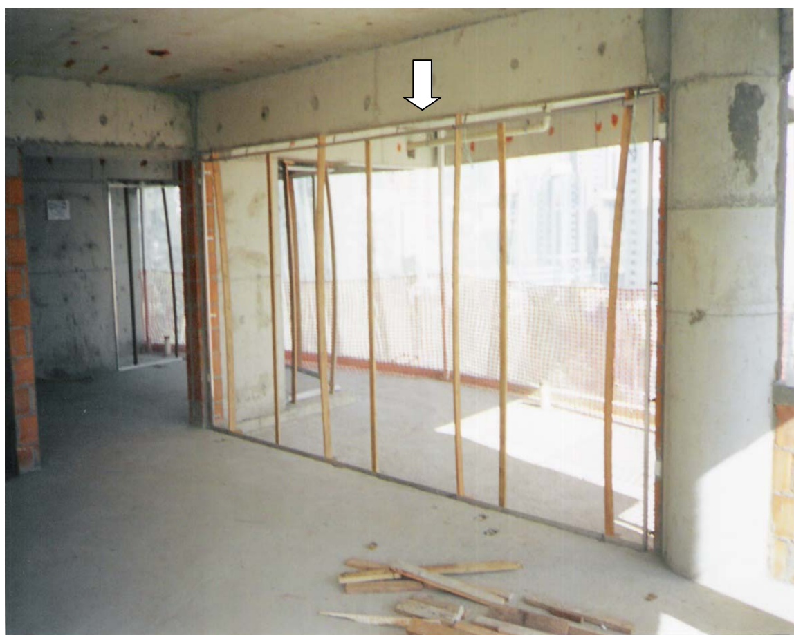
FIGURA 5.14 – Falta de construtibilidade para fixação do contramarco Fonte: Empresa pesquisada (Obra B)
