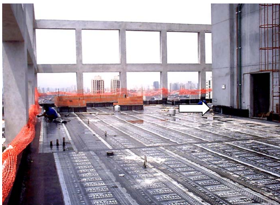
FIGURA 5.36 – Necessidade de barrado de argamassa na região de parede com manta asfáltica Fonte: Empresa pesquisada (Obra C)
