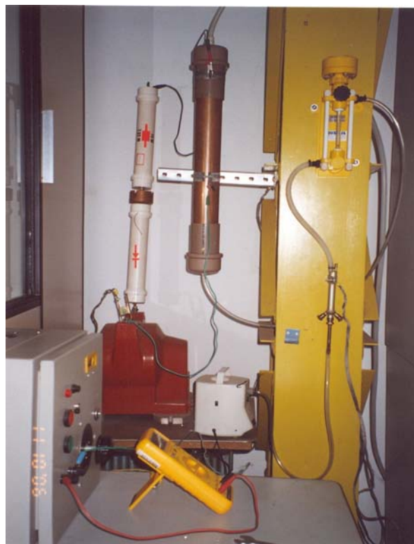
Figura 15. Montagem real do sistema a 03 (três) fios.
