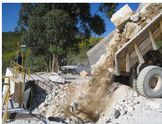
Figura 27 - Alimentação das instalações de britagem
