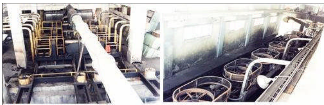
Figura 45 - Equipamentos de beneficiamento mineral de carvão
