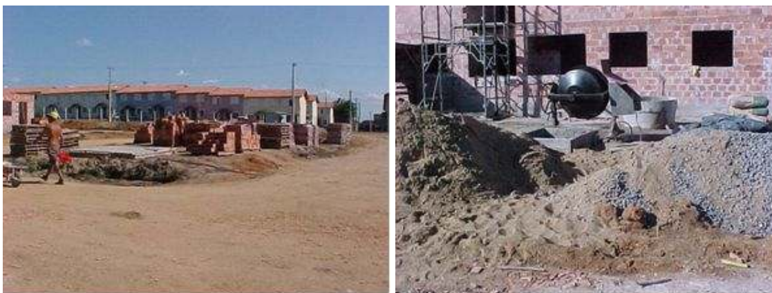
Figura 38: Estoque distante de blocos o que poderá acarretar em perda (à esquerda) e perda por contaminação de material devido à falta de baia.
