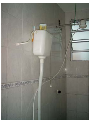
Fotografia 71: Caixa de descarga de baixo consumo de água instalada pela PMV Março 2007.
