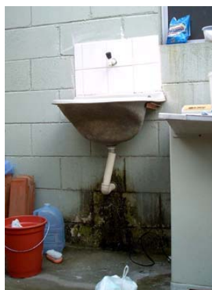
Fotografia 67: Mofo pontual causado por um antigo vazamento na tubulação hidráulica Fevereiro 2007.
