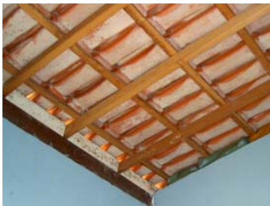
Fotografia 37: Telhas de barro com manchas Março 2007.
