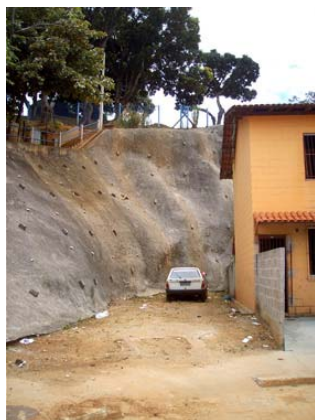
Fotografia 38: Muro de arrimo que limita o Residencial Março 2007.
