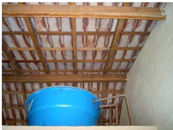
Fotografia 24: As casas foram entregues sem forro Fevereiro 2007.
