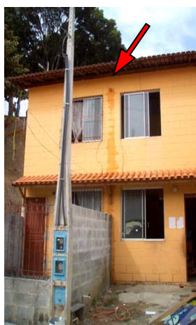
Fotografia 23: Extravasador de água na fachada frontal - parede molhada Março 2007.
