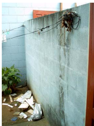
Fotografia 66: Manchas causadas pela exposição a chuvas Fevereiro 2007.
