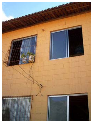
Fotografia 52: Detalhe da janela das casas Fevereiro 2007.
