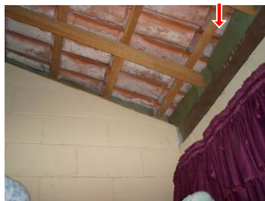
Fotografia 39: Seta indica espuma na fresta do telhado com a parede Março 2007.
