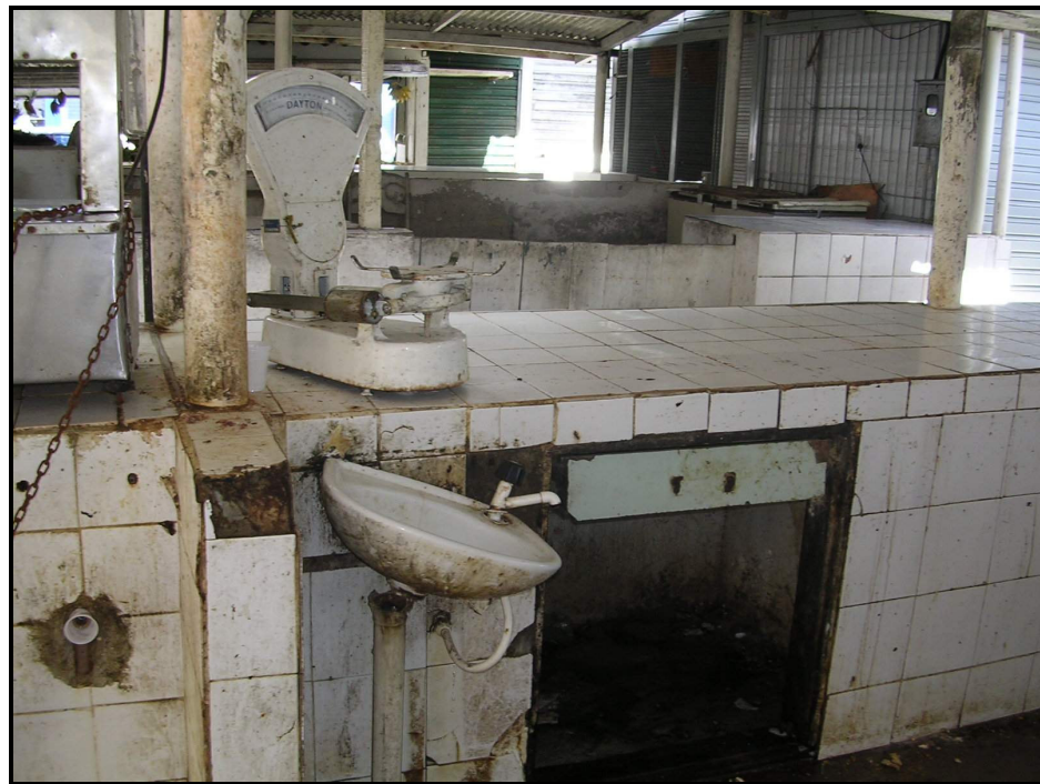
Figura 8 – Lavatório em condições impróprias para uso
