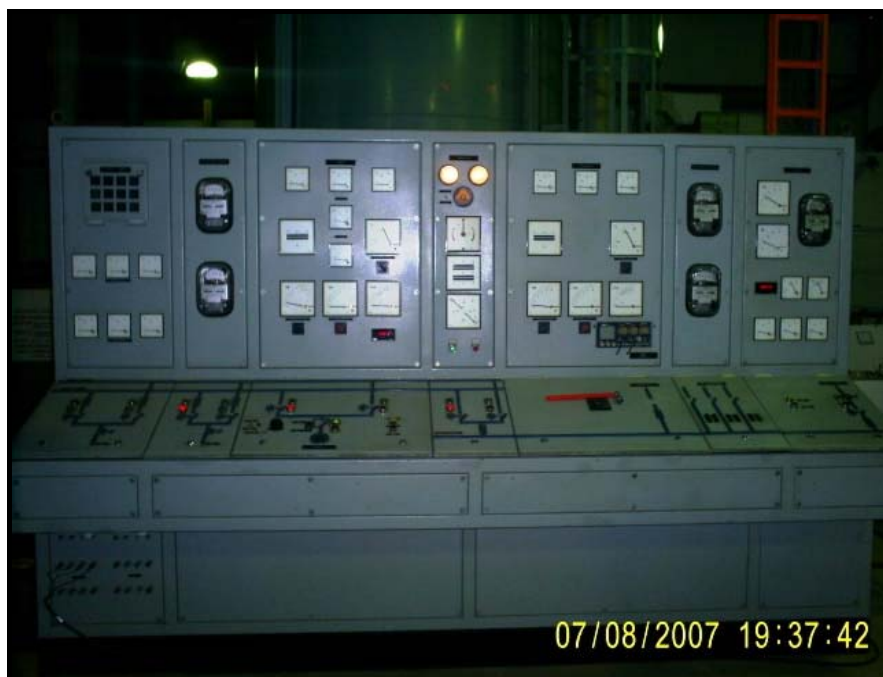
Figura 3-4 - Painel de comando de operações
