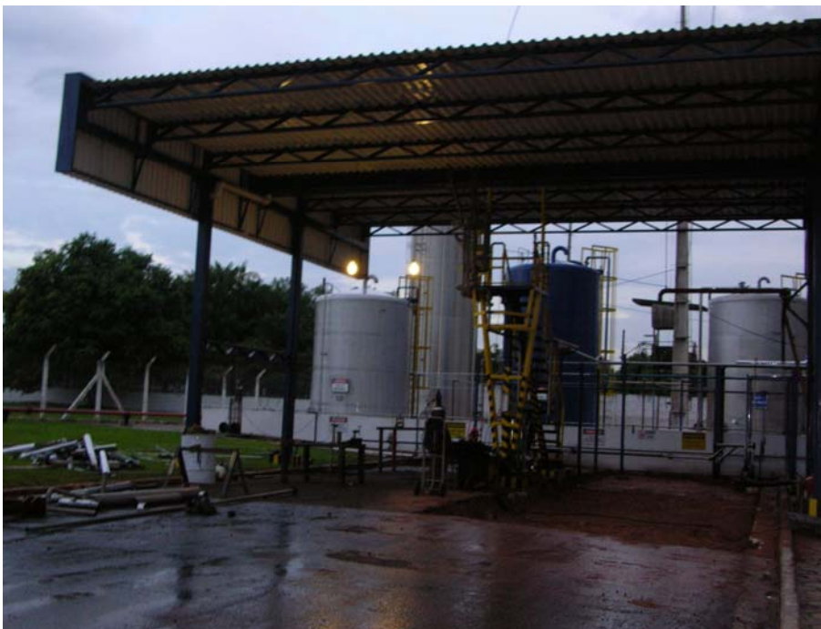
Figura 2.33: Tanques de Armazenamento de combustível
