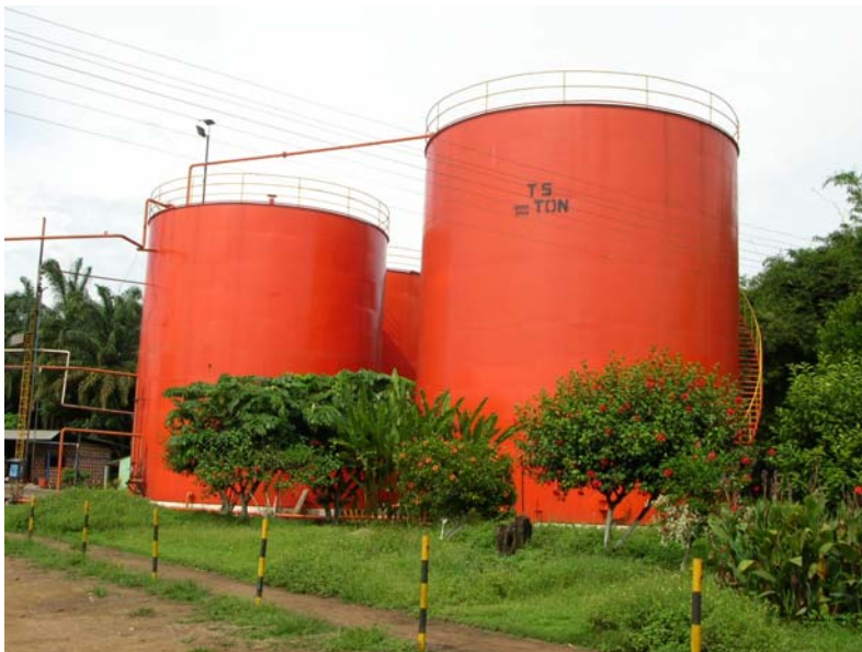
Figura 2.30: Tanque de armazenagem de óleo
