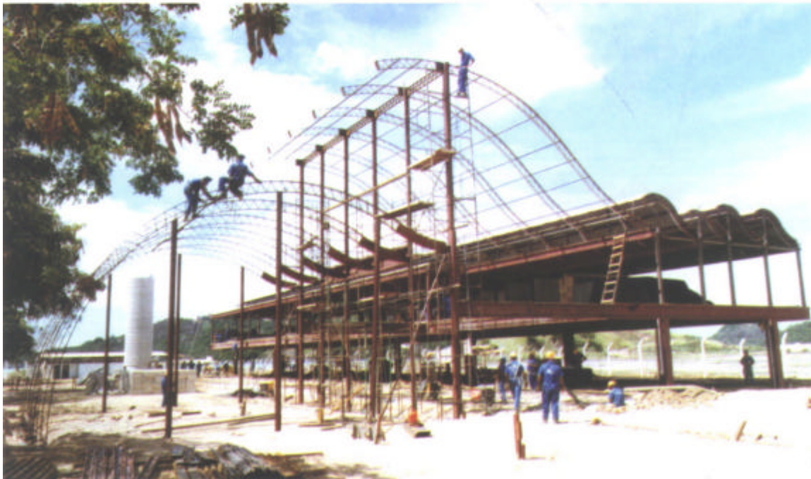
Figura 4.23 – Sede do Tribunal de Contas da União no Estado do Espírito Santo – CTRS – Vitória, ES, Brasil, 1998. Arquiteto: João Filgueiras Lima, Lelé. Croqui – corte transversal do edifício. Vista geral da construção, com as estruturas metálicas do auditório em primeiro plano, na fase de montagem.
