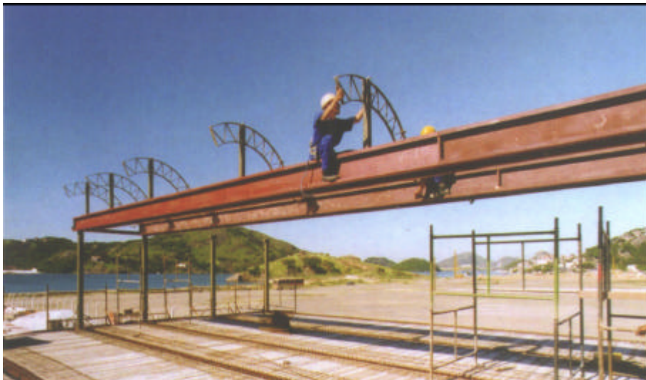
Figura 4.31 – Sede do Tribunal de Contas da União no Estado do Espírito Santo – CTRS – Vitória, ES, Brasil, 1998. Arquiteto: João Filgueiras Lima, Lelé. Treliza de cobertura dos sheds. Início da montagem das treliças de cobertura em forma de sheds.
