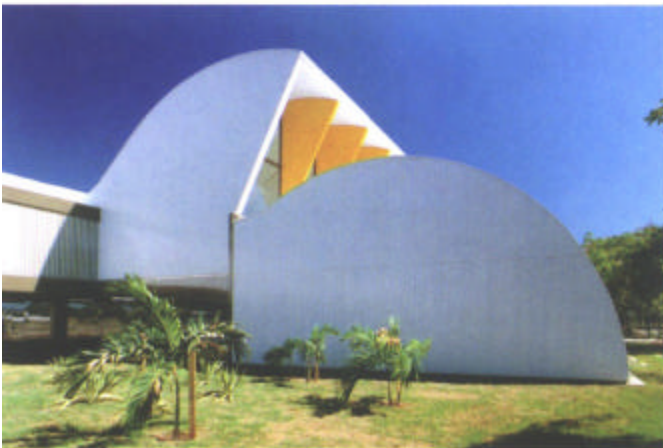
Figura 4.32 – Sede do Tribunal de Contas da União no Estado do Espírito Santo – CTRS – Vitória, ES, Brasil, 1998. Arquiteto: João Filgueiras Lima, Lelé. Estrutura do auditório, durante a montagem. Fechamento do auditório com as alvenarias de concreto celular.
