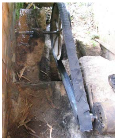
FIGURA 5H: Detalhe do gerador de energia elétrica.
