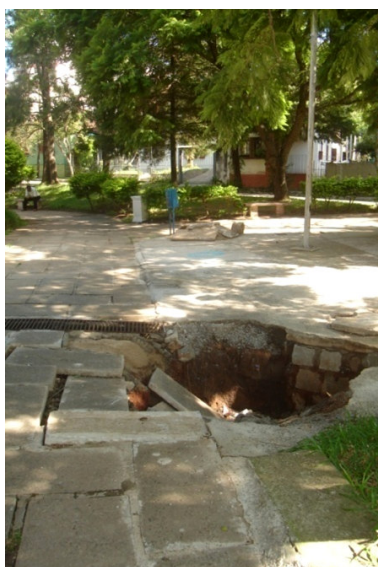
Figura 35 – Grande buraco causado pela infiltração no Setor 5 do parque, demonstrando descaso aliado ao uso de material com baixa qualidade
