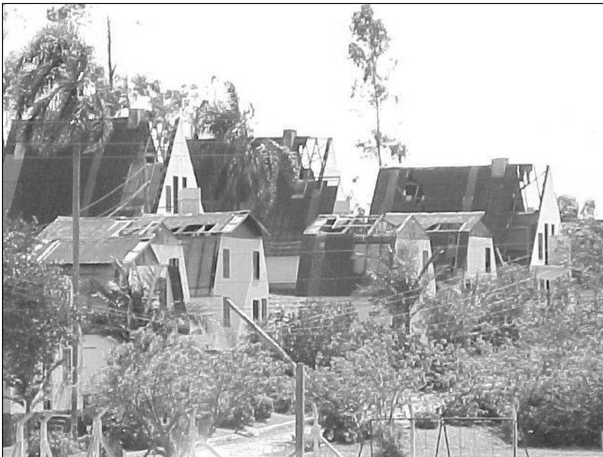
Figura 6.14 - Moradias destelhadas pelo furacão Catarina no município de Torres em março de 2004.
