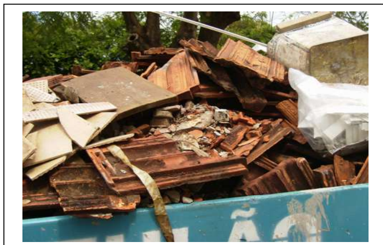
FIGURA 4.22 – Caçamba com volume depositado acima de sua capacidade
