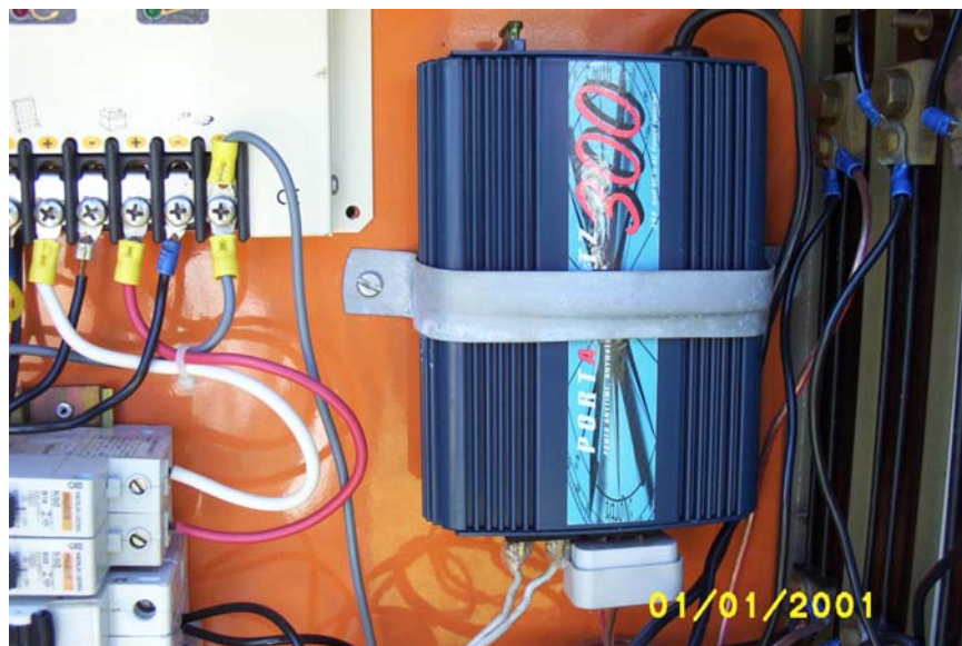
Figura 13. Inversor de tensão PWZ 300 de senóide modificada instalado no sistema.
