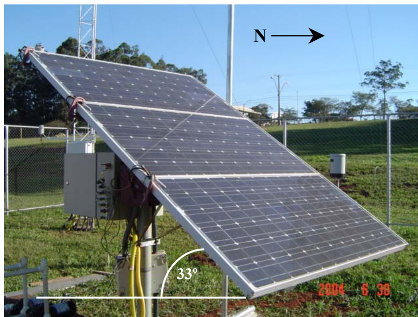
Figura 11. Módulos fotovoltaicos de 100Wp cada, instalados em paralelo e constituindo o painel fotovoltaico do sistema híbrido.
