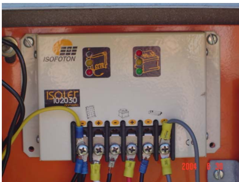
Figura 12. Controlador de carga ISOLER ligado ao painel fotovoltaico, bateria e cargas.
