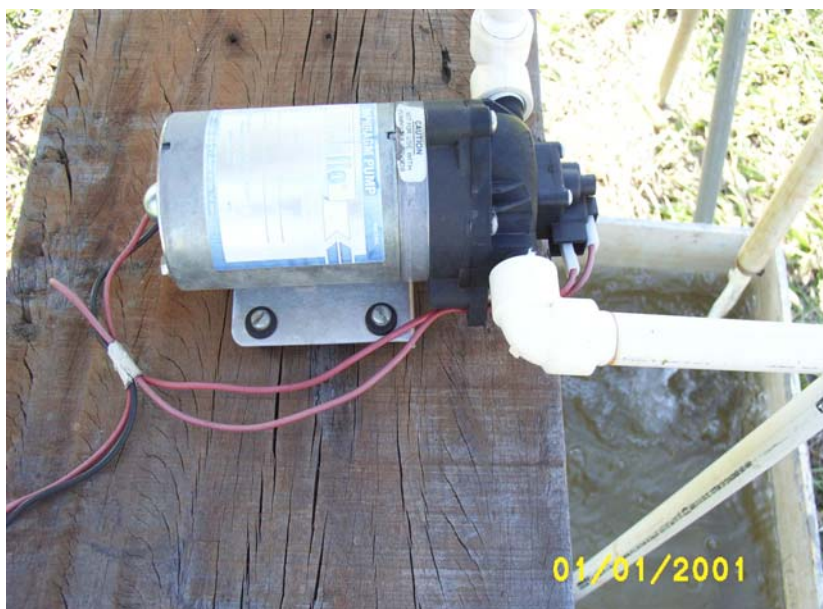
Figura 16. Detalhe da instalação da motobomba SHURFLO 8000 do sistema.
