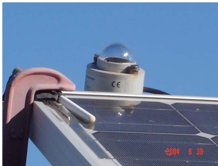
Figura 7. Piranômetro CM3 instalado na mesma inclinação dos módulos fotovoltaicos.
