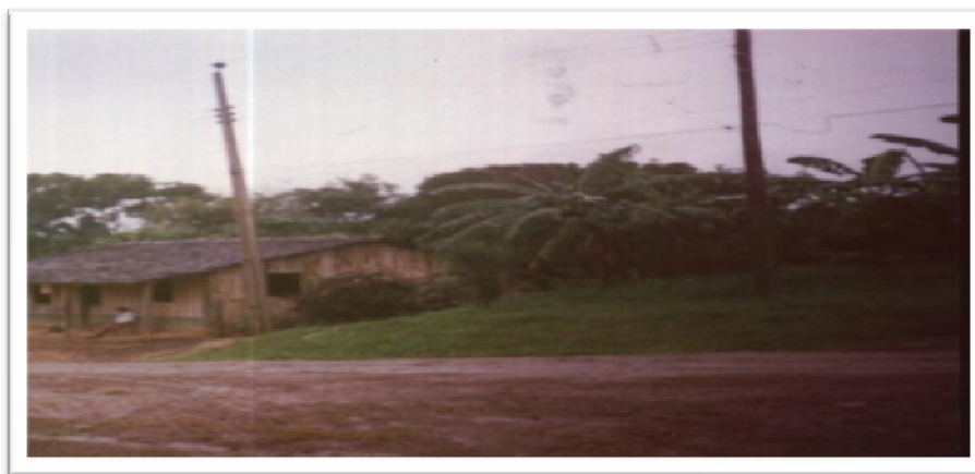
Figura 11 - ENERGIA ELETRICA NA COMUNIDADE
