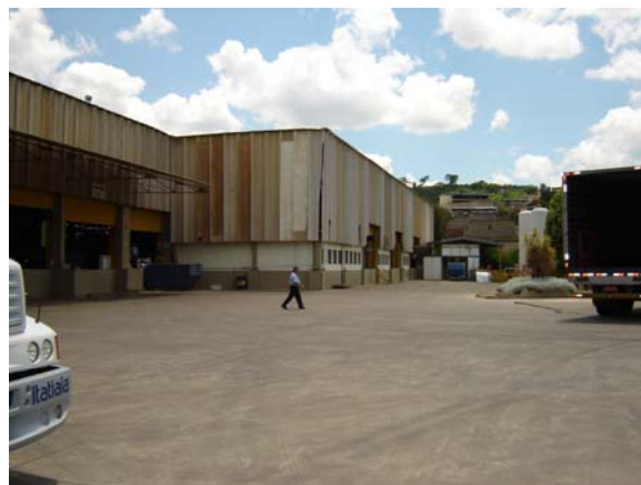
Figura 20 - Fechamento lateral por telhas de amianto.
