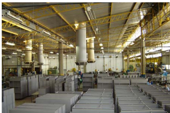
Figura 48 - Vista geral dos insufladores.
