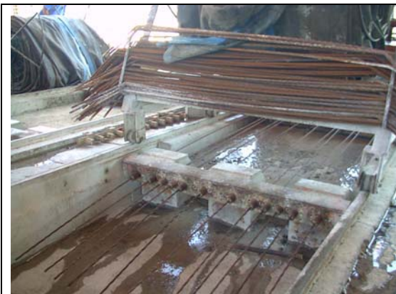
Figura AP-D-1 – Cabos ancorados
