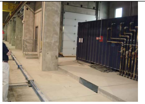
Figura AP-D-18 – Painel de controle temperatura pista
