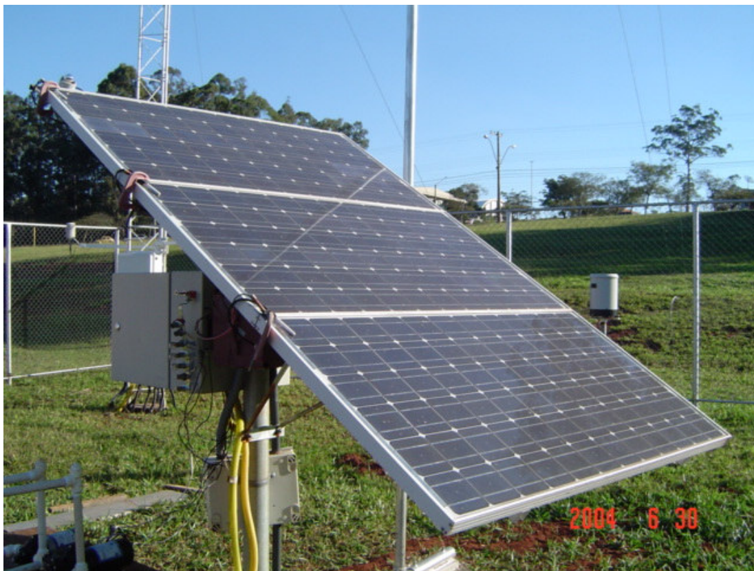
Figura 10. Módulos fotovoltaicos de 100 Wp cada, instalados em paralelo e constituindo o painel fotovoltaico do sistema híbrido.
