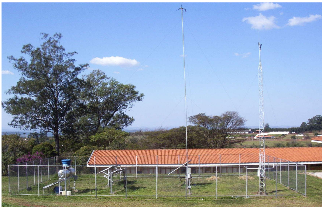
Figura 8. Vista panorâmica do NEAR e da instalação do sistema híbrido eólico fotovoltaico.
