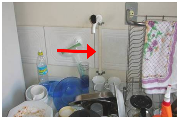
Figura 46: tubulação aparente de água da torneira da pia da cozinha nos sobrados
