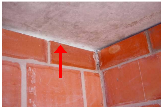
Figura 58: desnível da cinta de respaldo
