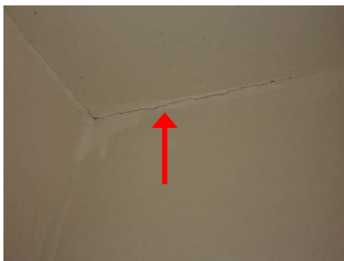
Figura 41: fissura na interface do apoio da laje sobre a parede
