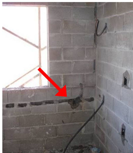
Figura 52: cortes horizontais excessivos na alvenaria
