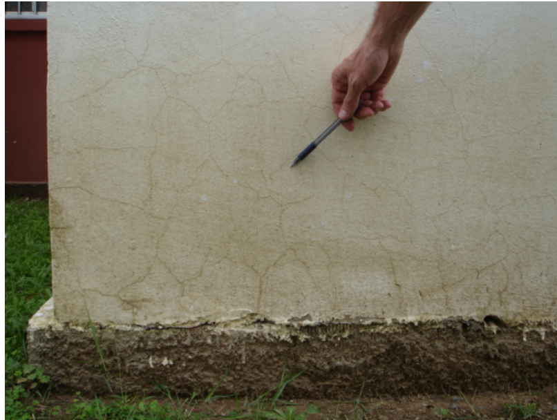
Figura 32: fissuras mapeadas localizadas na fachada da edificação
