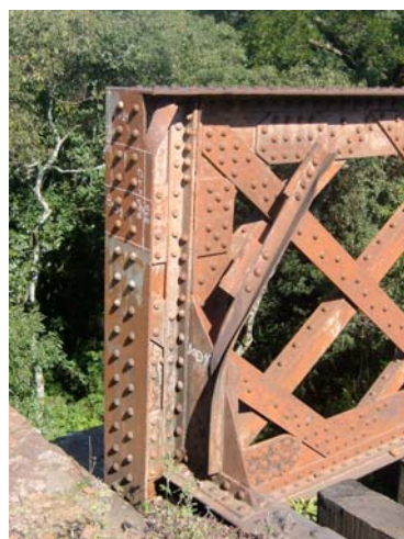
Figura (5.3) – Peças do contraventamento vertical – brackets – deformados por choques.
