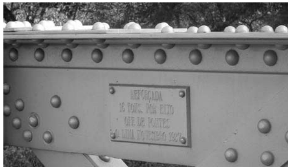
Figura (5.2) – Placa de identificação do reforço que foi realizado em 1937.
