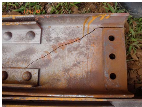
Figura (5.5) – Detalhe da trinca por fadiga numa das longarinas substituídas.
