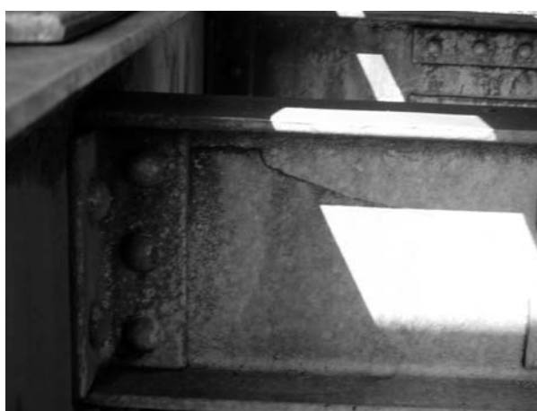
Figura (1.4) – Detalhe de trinca por fadiga na alma da longarina.
