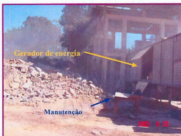
FIGURA 35 – Usina C – Serviço de manutenção realizado pelo encarregado geral (próximo ao gerador de energia)
