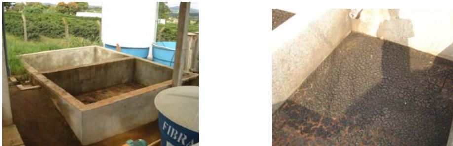
FIGURA 18. Leito de secagem para receber o lodo das unidades do sistema piloto de tratamento da água residuária do café, localizado no NECAF/UFLA.
