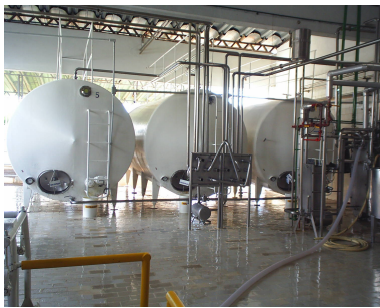
Estocagem em tanque horizontal isotérmico de leite cru
