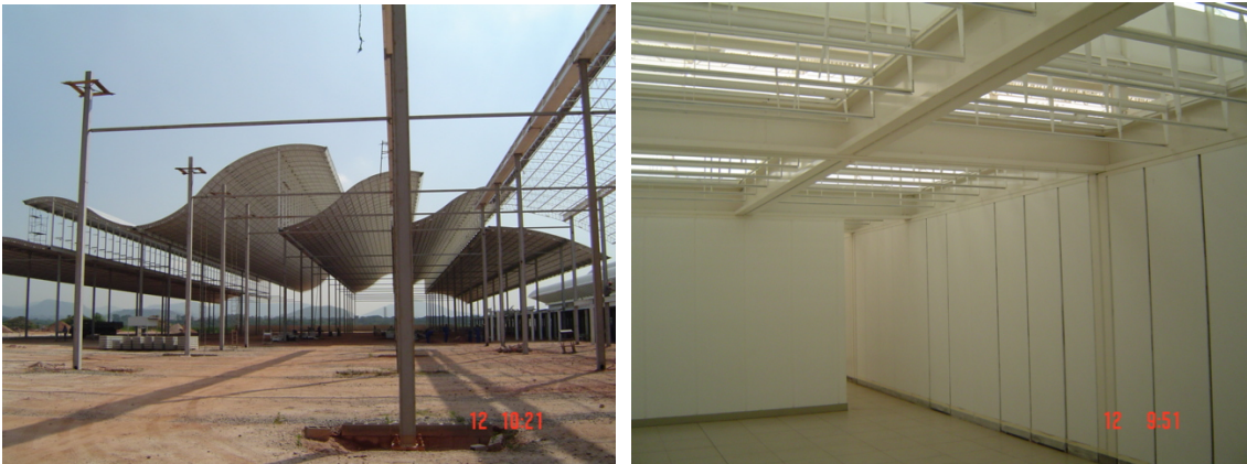
Figs. 34 e 35: Hospital Sarah do Rio de Janeiro (em construção), onde o arquiteto está testando novas soluções de cobertura, visando o conforto ambiental Fonte: Espaço Saúde, 2004
