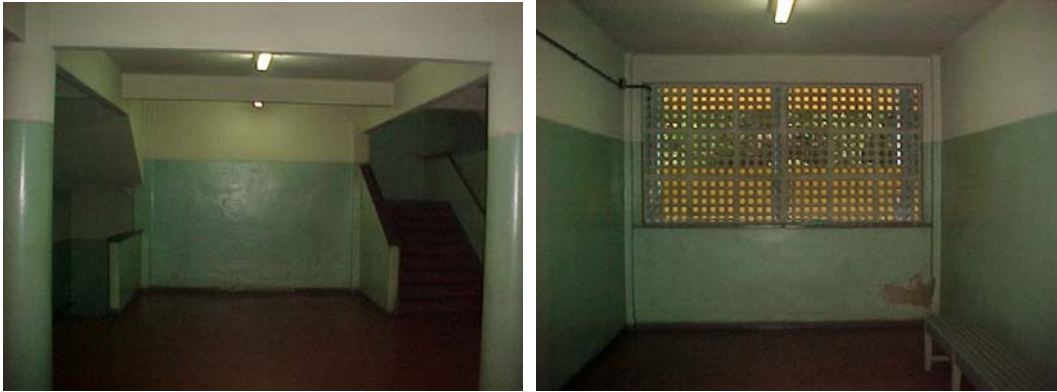
Figs. 112 e 113: Hall do pavimento tipo Fonte: Espaço Saúde, 2002
