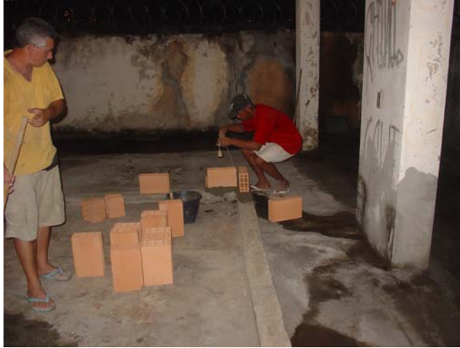
FIGURA 13 - Início da execução da alvenaria para revestimento argamassado sobre base cerâmica (sem chapisco).
