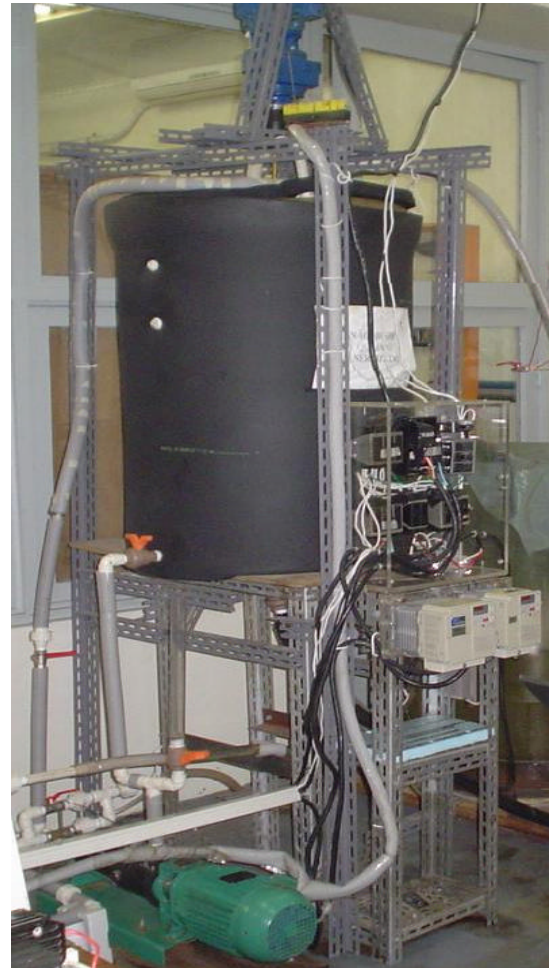
Figura 21 – Tanque de armazenamento primário.
