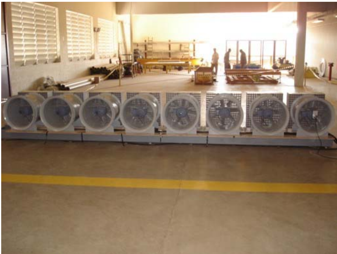
Figura 4.18 – Banco de Ventiladores montado na base nivelada.
