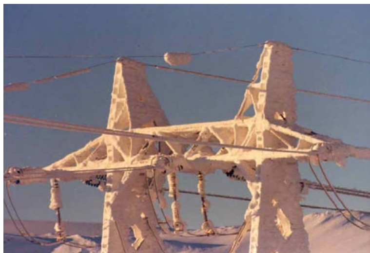
Figura 1.3 - Torre de transmissão atingida por tempestade de neve, no Canadá, 1998. Fonte: (ROGIER, 2006)
