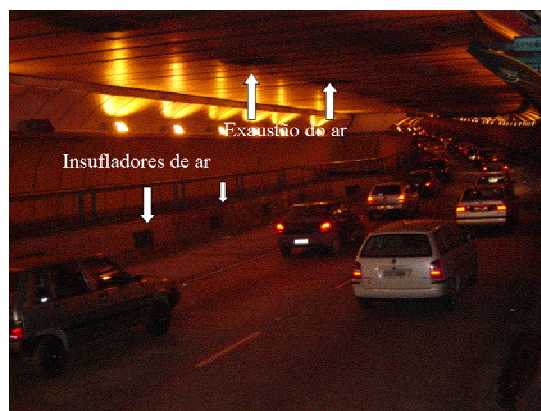
Figura 4.1: Vista interna do TJQ. As setas indicam a localização do sistema de ventilação.
