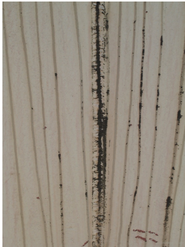
Figura 3. Cordão de solda com acúmulo de sujeira e oxidação pertencente a um tanque de armazenamento da PETROBRAS/REDUC.
