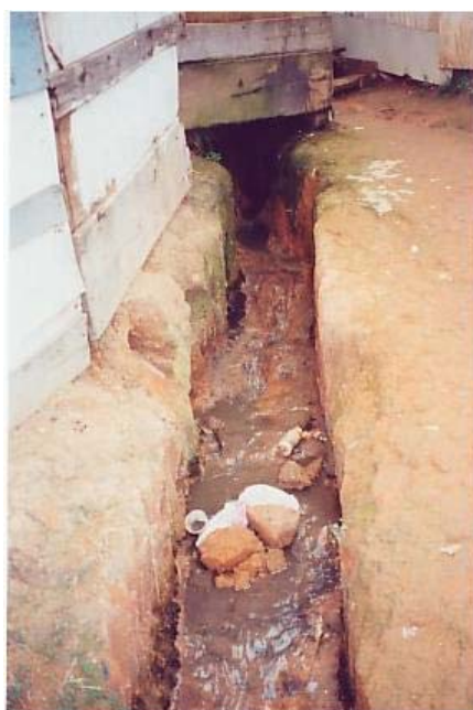
Fotografia 37: Esgoto a céu aberto que passa por baixo de barracos.
