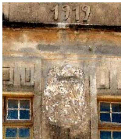
Figura 86: Detalhe da fachada da edificação à rua dos Coelhos, 222. Bairro dos Coelhos – Recife – PE. Fonte: acervo do autor.
