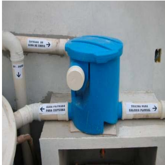
Figura 20. By Pass, importante para se evitar um transbordamento provocado pelo excesso de chuva.
