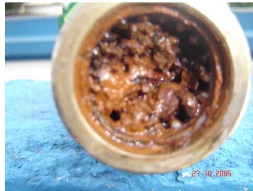
vista aproximada do filtro
