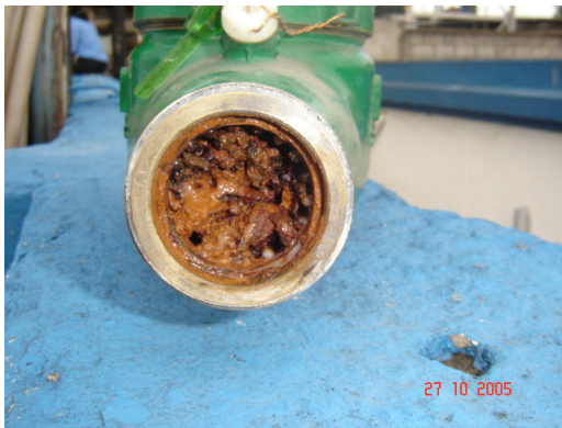
vista do filtro de entrada
