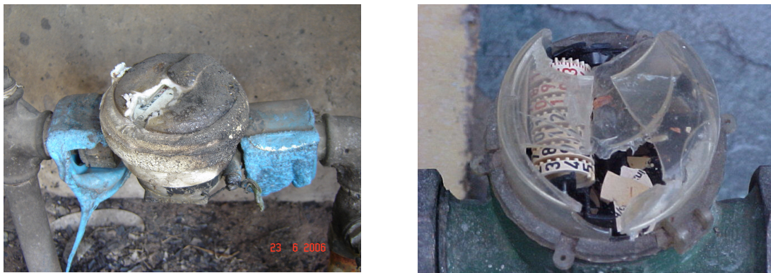
Figura 3.10 – Hidrômetros com ocorrência de vandalismo.
