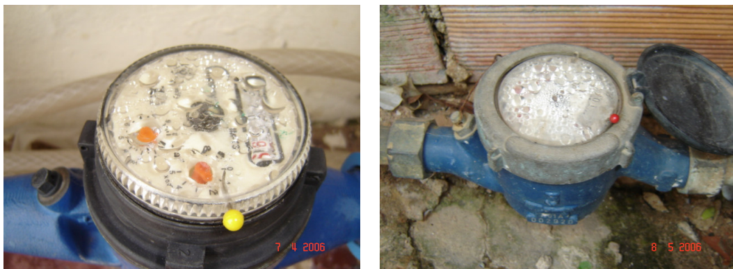
Figura 3.9 – Medidores violados com furo na cúpula.
