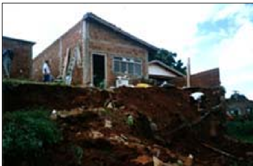
Foto 6: Muro de Arrimo Derrubado pela Enxurrada.
