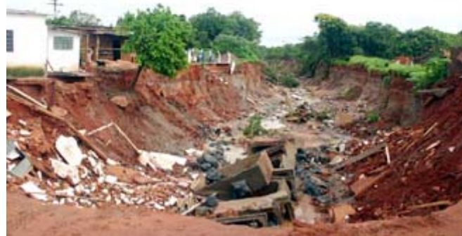
As chuvas que caíram nos últimos dias provocaram o rompimento da galeria, no Jardim Santo Expedito
