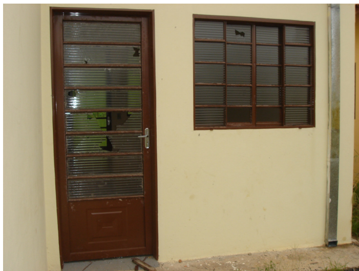
Figura 23 - Depredação antes da ocupação de uma das casas do Residencial Leo Gomes de Moraes.
