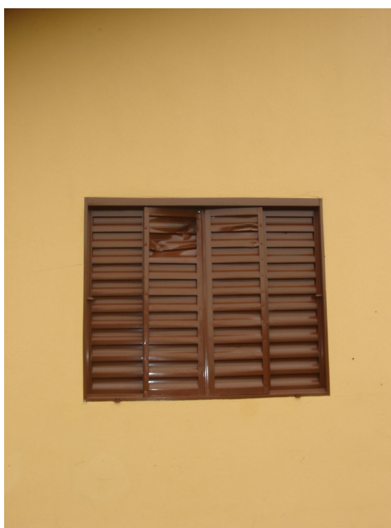
Figura 24 - Sinais de tentativa de arrombamento em uma das casas do Residencial Leo Gomes de Moraes, antes de ser ocupada.
