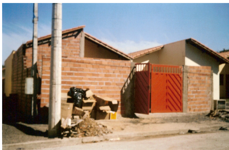
Figura 11 - Casa de arrendatário, localizada na rua Magda Regina Lellis Siansi nº 80, antiga rua 12, durante as obras de reforma.
