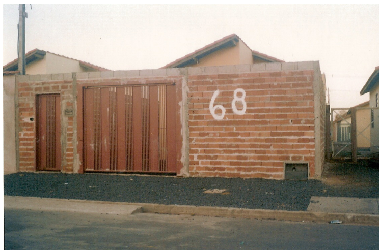
Figura 17 - Casa de arrendatário durante as reformas, que incluíram muro, portão e pintura interna de paredes e piso.
