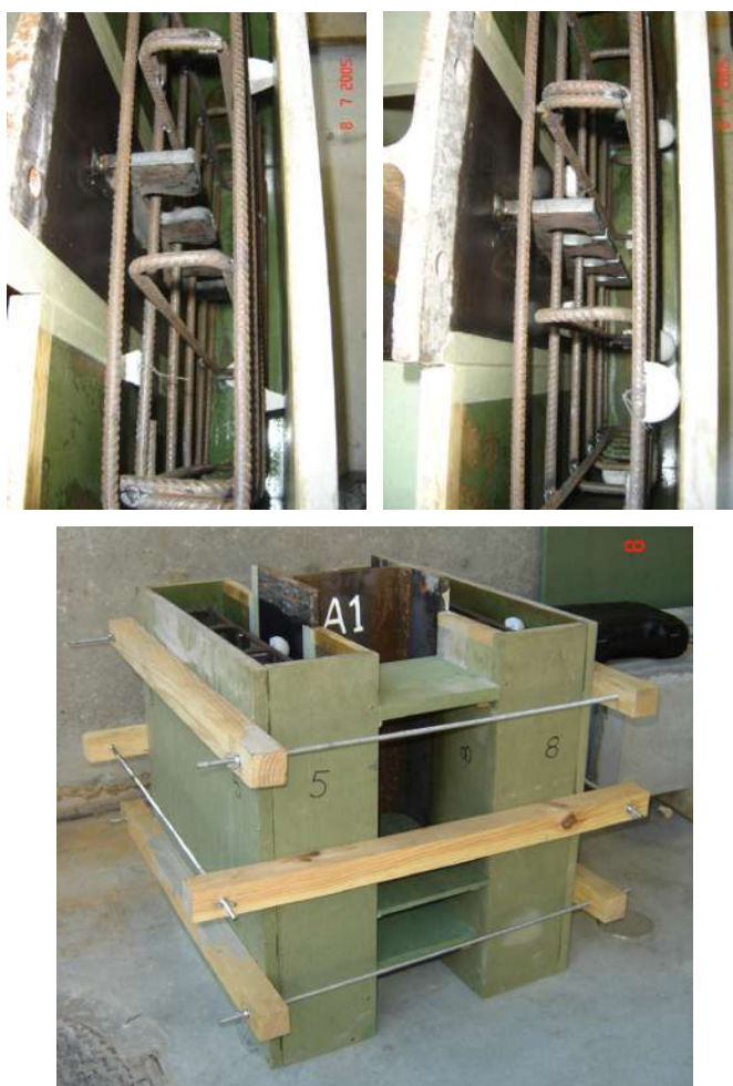
FIGURA 3.52 – Montagem dos modelos X1 e X2 – armaduras colocadas e modelo pronto para concretagem.
