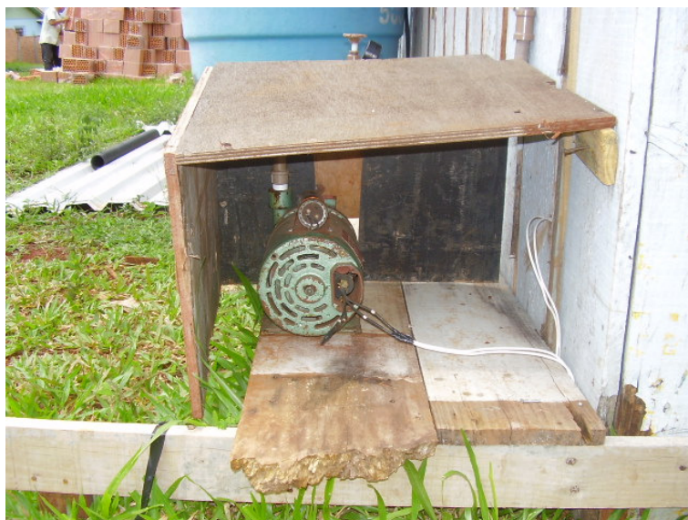
Figura 11 - Vista interna da instalação da moto-bomba hidráulica.
