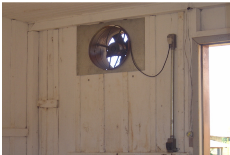
Figura 14 - Vista interna da instalação do exaustor axial.
