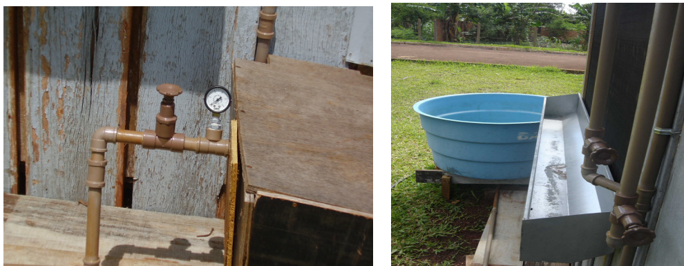
Figura 23 - Medidor de pressão, registro de vazão, calha e reservatório de água.
