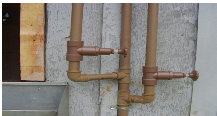
Figura 13 - Circuito de circulação de água e registros de fluxo.
