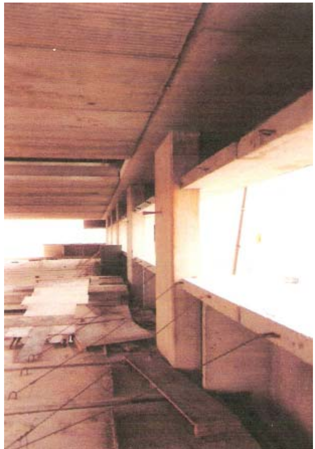
Figura 65 - Novamente a Caixa Lateral e Laje pré-moldada com as canaletas embutidas, em execução.
