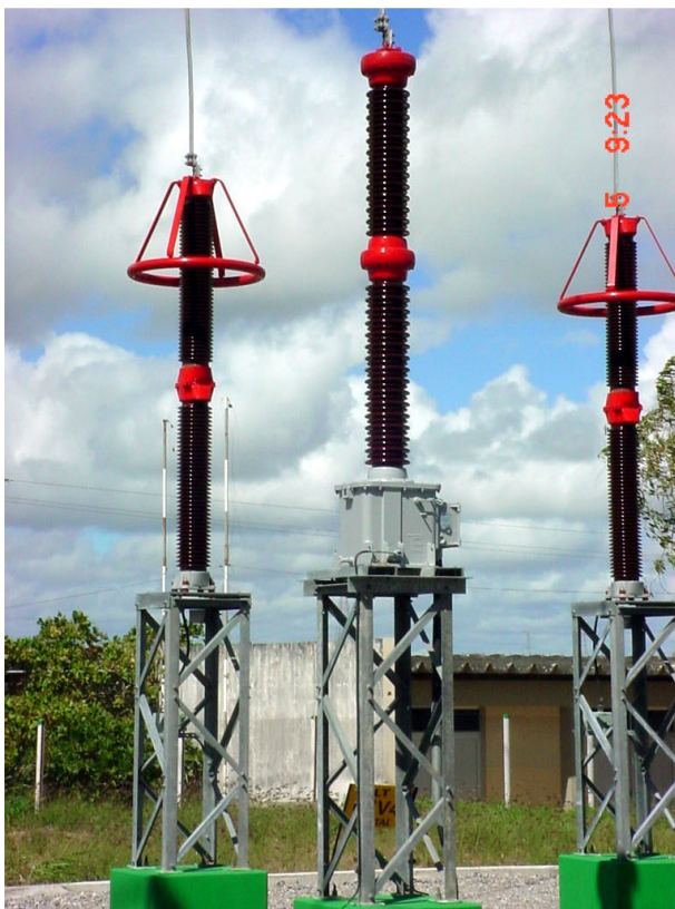
Figura 5.5.1 - Transformador de Potencial e Pára-Raios de ZnO.
