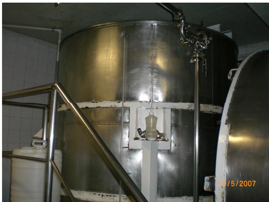
Figura 2 – Tanque de mistura.
