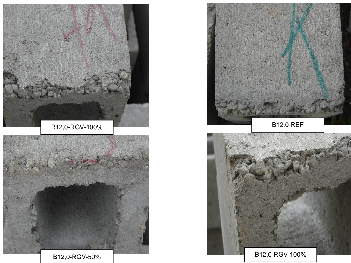
Figura 7.18 – Defeitos na face inferior de algumas unidades dos traços B12,0-REF, B12,0-RGV-100% e B12,0-RGV-50%.
