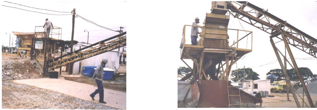
Figura 2.14 – Processamento dos resíduos de concreto no canteiro de obras (foto do autor).
