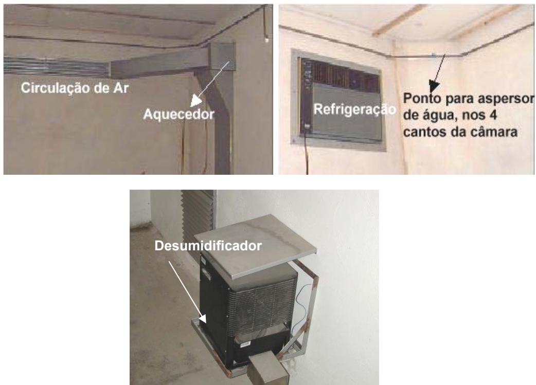
Figura 9.10 – Equipamentos de refrigeração, aquecimento, desumidificação e umidificação existentes na câmara climatizada.
