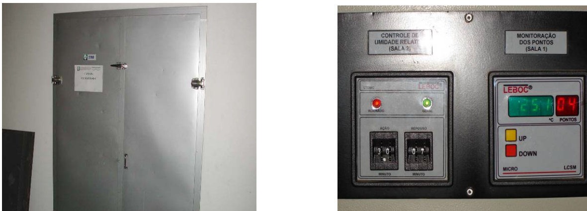
Figura 9.7 – Câmara climatizada com controle de umidade e temperatura.
