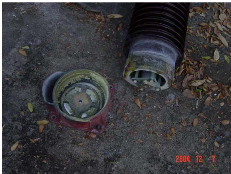
Fig. 25 – Base do pára-raios após abertura.
